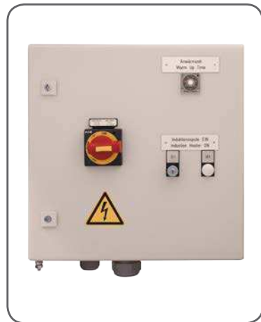
Bild 5 Netzanschluß über den Schaltschrank
